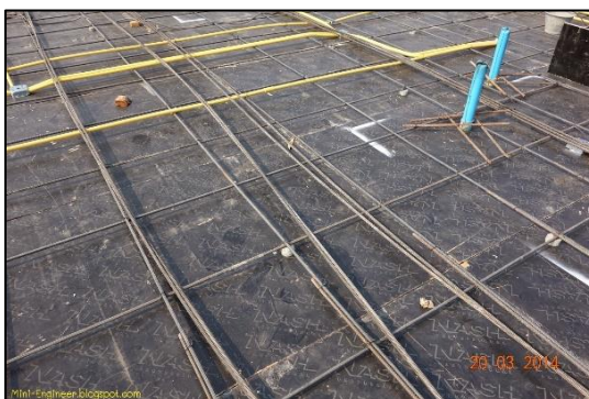
รูปที่ 2.2 การติดตั้งไม้แบบในระบบพื้น Post Tension
