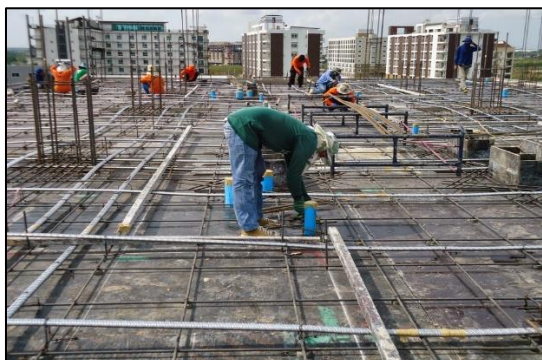
รูปที่ 2.3 การวางเหล็กและเหล็กเสริมในระบบพื้น Post Tension
