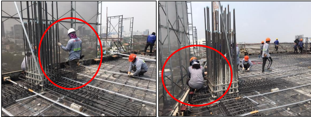
รูปที่ 4.28 ตัวอย่างการทำงานที่ไร้ประสิทธิภาพของงานวางลวดสลิง งานร้อยท่อสังกะสีแบบลอน งานติดตั้ง Bar-Chair งานติดตั้งอุปกรณ์สมอยึดลวดและงานติดตั้งท่ออัดน้ำปูน
