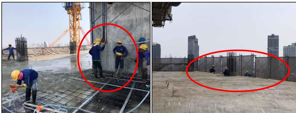
รูปที่ 4.32 ตัวอย่างการทำงานที่ไร้ประสิทธิผลของงานเทคอนกรีต
