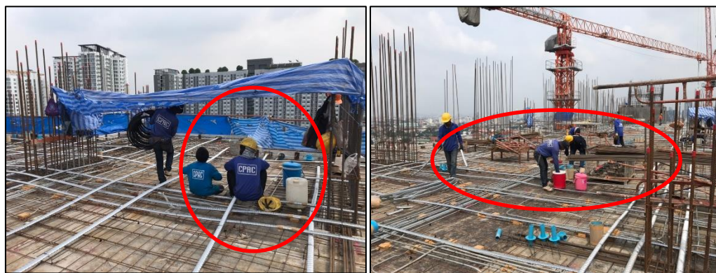
รูปที่ 4.14 ตัวอย่างการทำงานที่ไร้ประสิทธิผลของงานวางลวดสลิง งานร้อยท่อสังกะสีแบบลอน งานติดตั้ง Bar-Chair งานติดตั้งอุปกรณ์สมอยึดลวดและงานติดตั้งท่ออัดน้ำปูน
