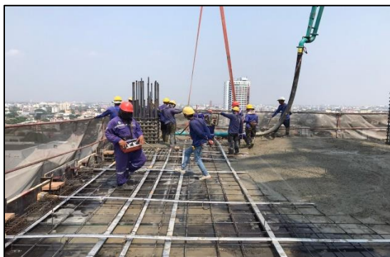
รูปที่ 2.5 งานเทคอนกรีตพื้นในระบบพื้น Post Tension
