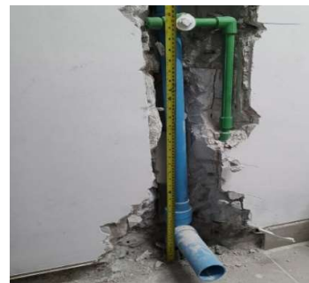
รูปที่ 4 ความเสียหายการแก้ไขงานติดตั้งท่อน้ำทิ้งและท่อน้ำดีอ่างชักล้างไม่ตรงตามแบบที่ผู้ออกแบบกำหนดไว้
