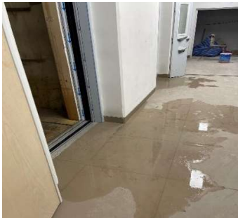
รูปที่ 1 ความเสียหายที่เกิดจากท่อน้ำฝนรั่วไหลลงลิฟท์และปล่องลิฟท์
