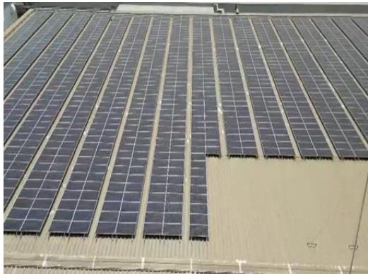
รูปที่ 1 แผงเซลล์แสงอาทิตย์ติดตั้งบนหลังคาอาคาร
