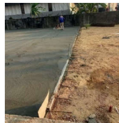
รูปที่ 12 การเทพื้นจากคอนกรีตที่เหลือจากงานคานและพื้น
