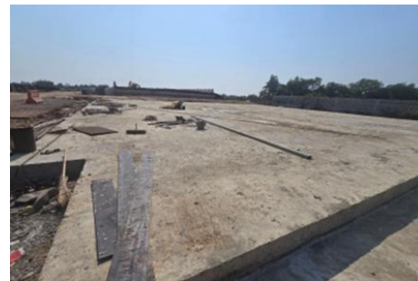
รูปที่ 23 งานก่อสร้างพื้นคอนกรีตเสริมเหล็กบริเวณคอสะพาน
